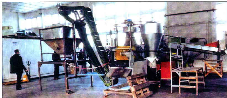
Teil der stationären Rüttel- und Säuberungsanlage, Quellendorf.
